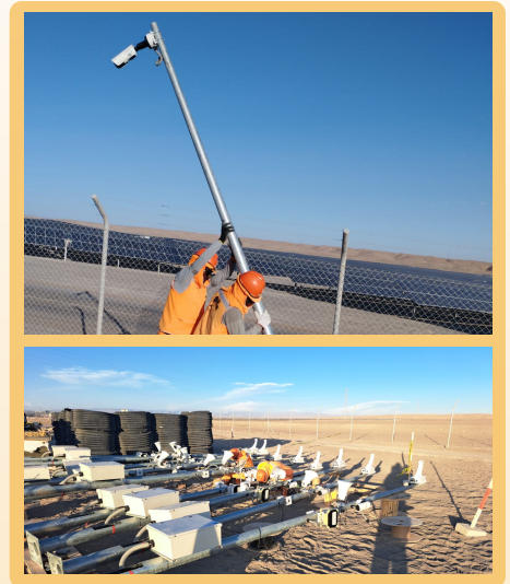
INSTALACIÓN DE SEGURIDAD Y COMUNICACIÓN
